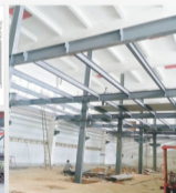
△ 罗村合丰钢构平台 4800㎡ WOORI HENG PLATFORM
